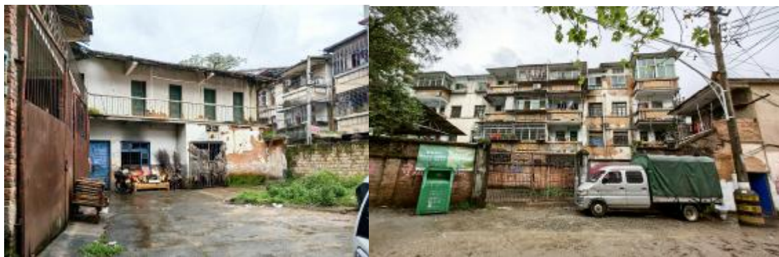
图 5-1 环卫站现状外墙破损严重
