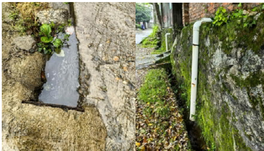
图 5-3 周边道路雨水溢出、雨污合流至水沟
