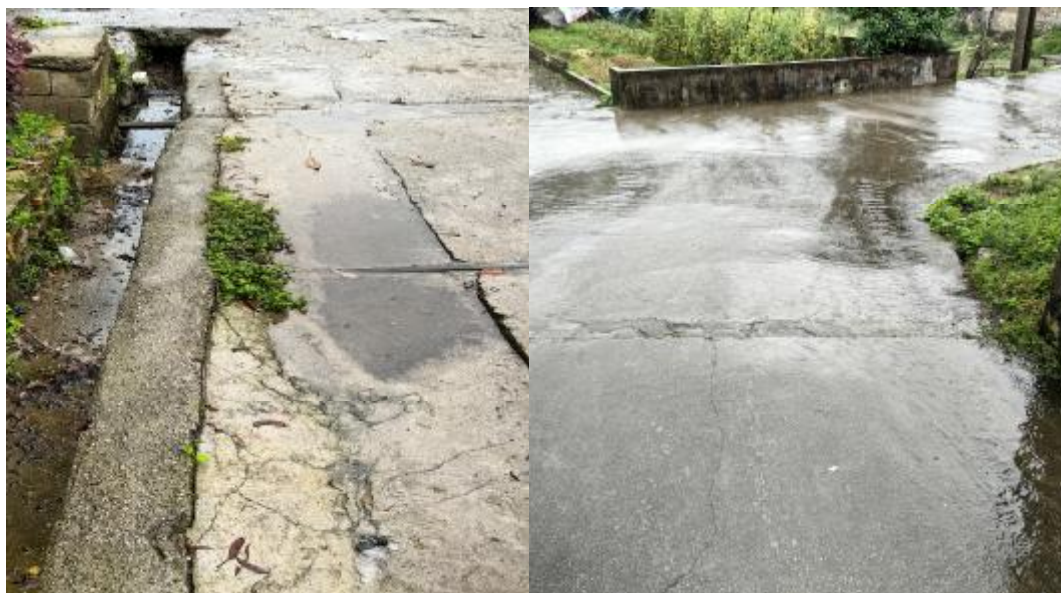
图 5-4 路面塌陷、积水
